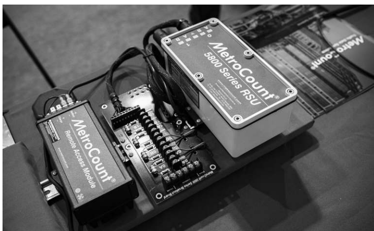
Contador, tablero de control y modem 3G.
